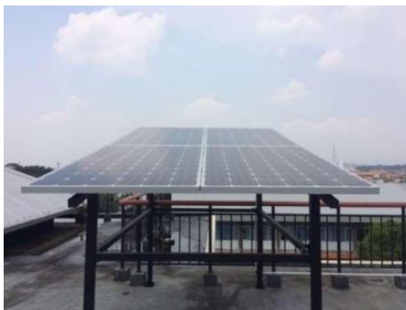
Gambar 1. Instalasi FV PLTS Institut Teknologi Nasional Bandung
